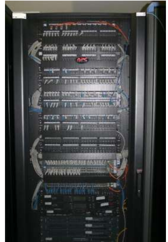
Bastidor de Distribuição
