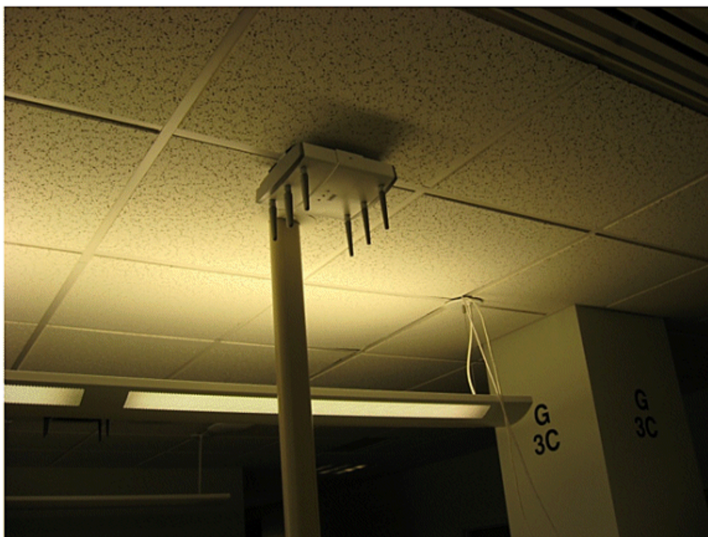
Figura 12: Ubicación deficiente del punto de acceso: el punto de acceso se sitúa cerca de la obstrucción física
